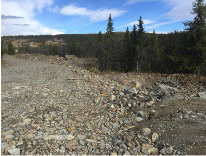
Foto 6: Regulert veg øst i planområdet er grovplanert og mangler toppdekke.
