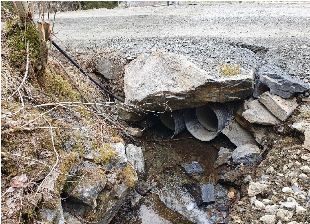
Figur 5: Stikkrenne D under Jotungløttvegen.
