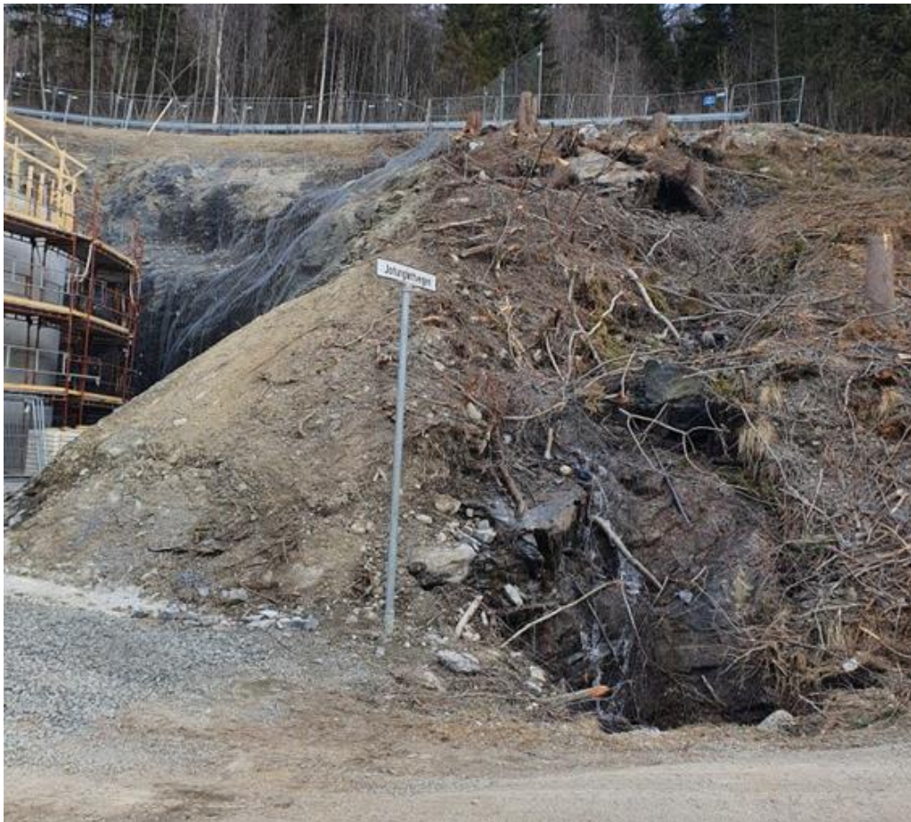
Figur 9: Høydebassenget til venstre i bildet, og Rudsbekken til høyre. Vann fra bekken har tidligere dratt ned mot høydebassenget.
